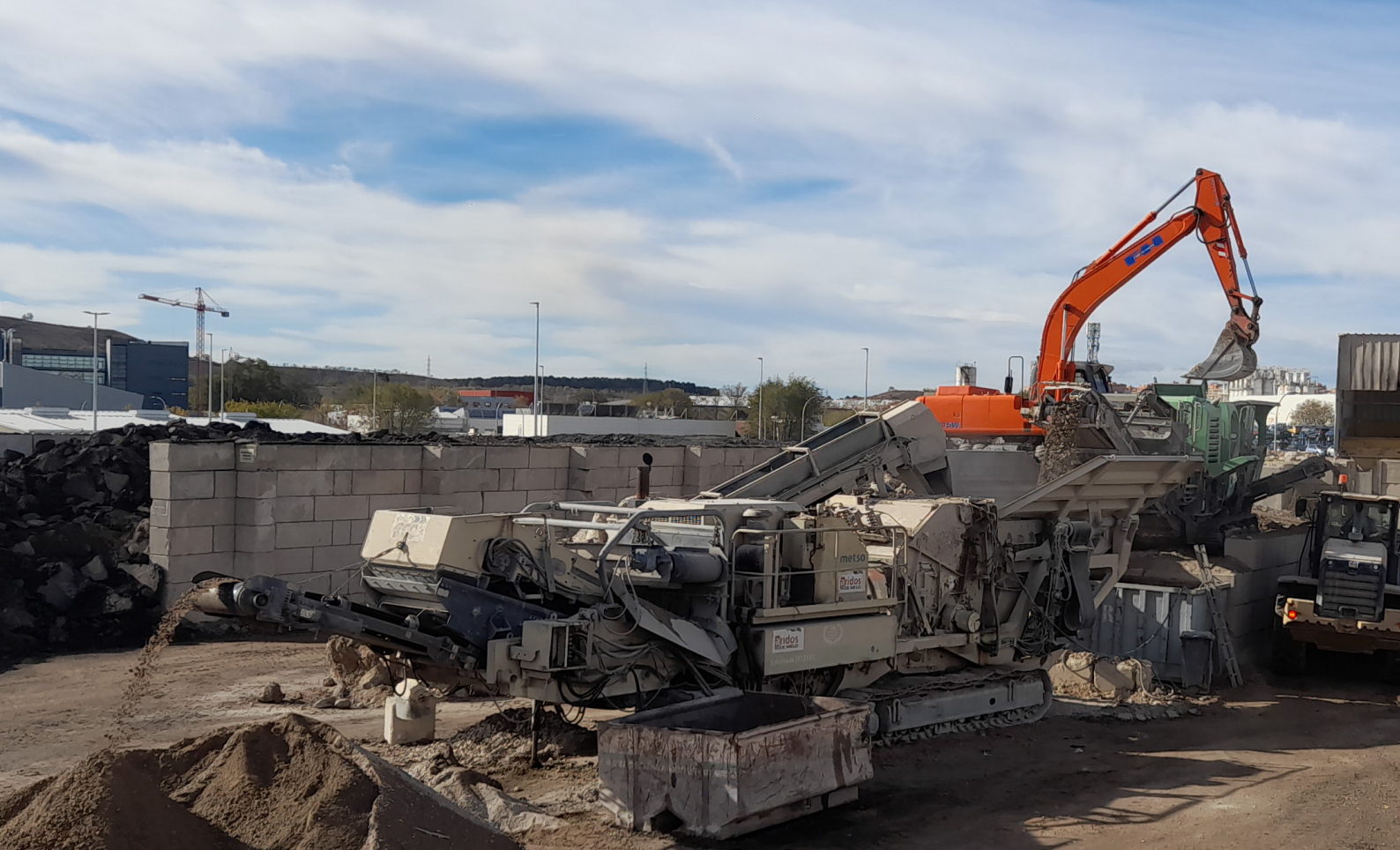
Planta de gestión de Residuos de Construcción y Demolición. Madrid (España)
